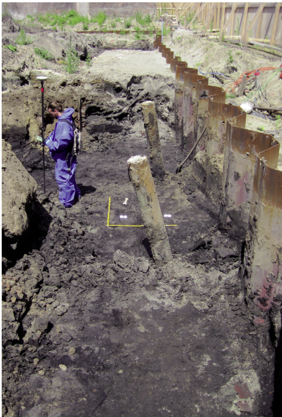
Afbeelding 38: Archeoloog bezig met het digitaal inmeten van sporen, die zijn aangetroffen tijdens de plaatsing van de damwand.
